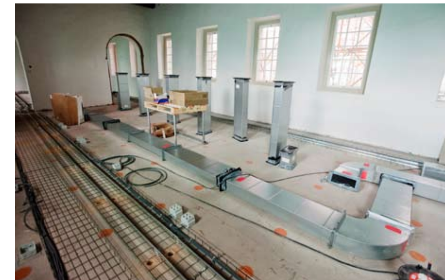
Onder de verhoogde vloer liggen alle luchtbehandelingkanalen voor de vitrines.
